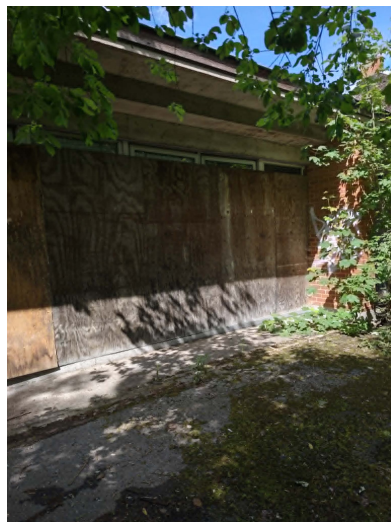
Arbres et branchages accumulés autour du bâtiment
