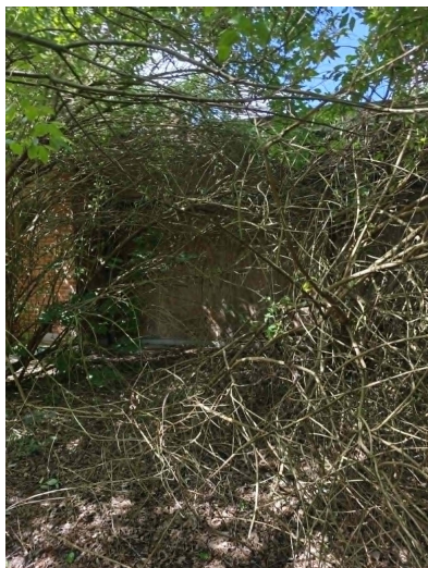
Façade condamnée et site dégradé
