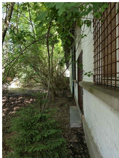
Fenêtres grillagées et abords non entretenus
