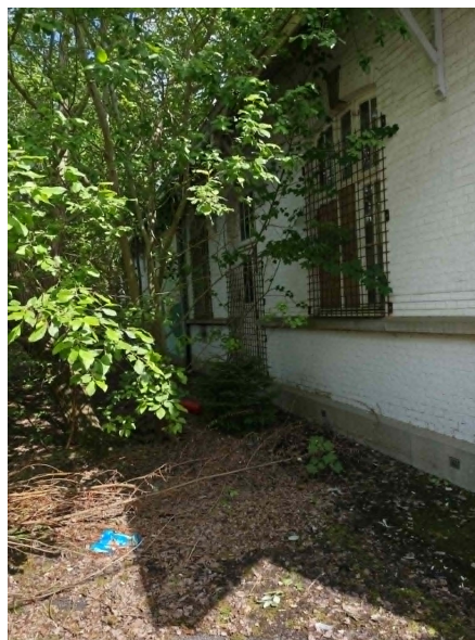
Façade et accès masqués par la végétation
